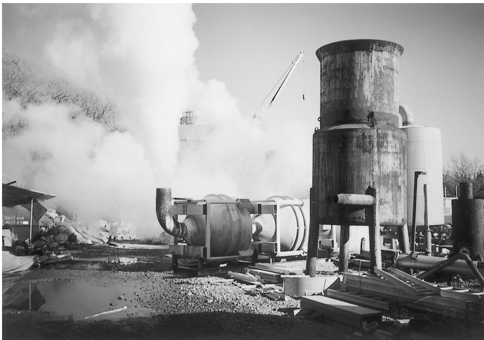
写真 29 九重観光ホテルの自家発電風景
