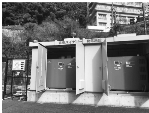
写真7 バイナリー発電所
