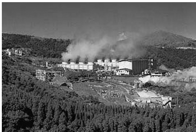
写真 1 八丁原発電所
